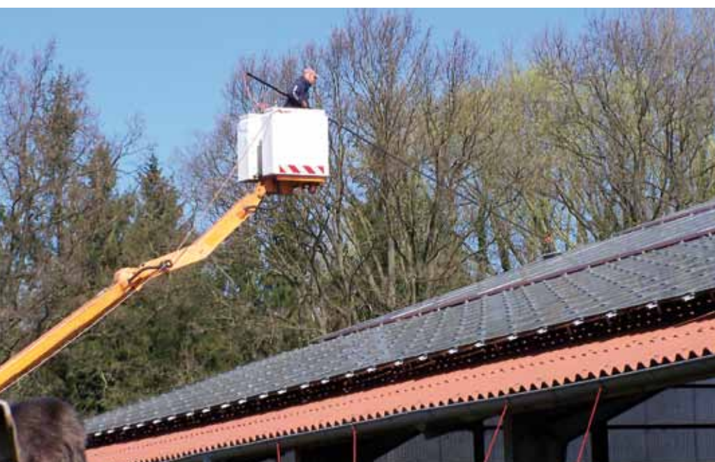
Reinigen der PV-Anlage mit Hilfe einer Hubarbeitsbühne – mit diesem Gerät können fast alle Module auch bei unterschiedlichen Befestigungssystemen erreicht werden Foto: Tralau
